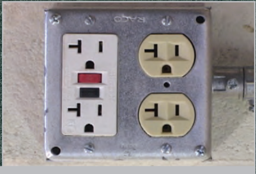
Toma de corriente GFCI
