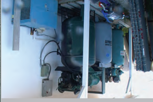
Receptores de aire (tanques)
